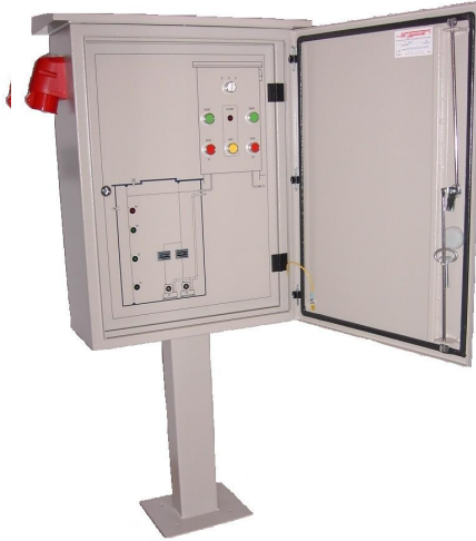
ST-1 ; ST-2 - na 2 pompy
